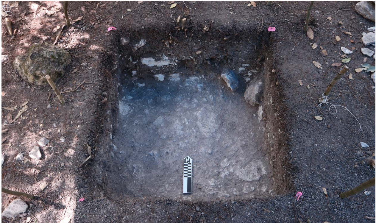
Figura 4.10. Operación 53A, lote 4. Piso deteriorado en el patio norte de Yab Na.
